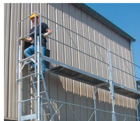
Passage au niveau supérieur en toute sécurité
