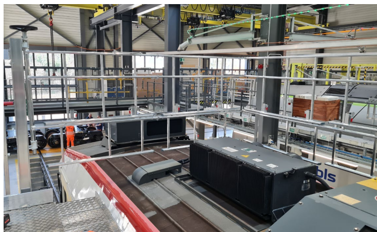
Entfaltbares Geländer auf dem Zugdach
